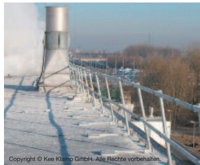
Bild 3-13: Nachträglich aufgestelltes Geländer
