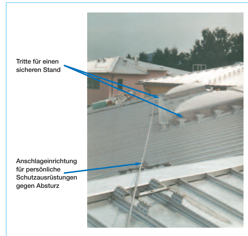
Bild 3-22: Anschlageinrichtung und Tritte auf einem geneigten Dach
