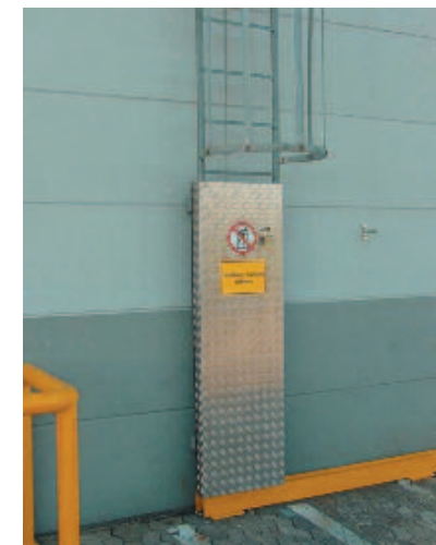
Bild 3-1: Steigleiter mit verschließbarer Abdeckung und Hinweisschildern
