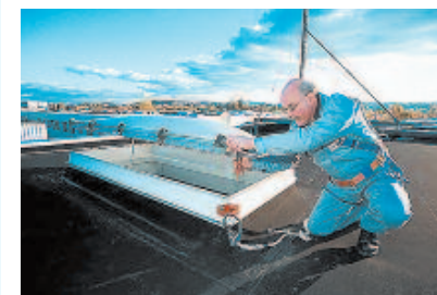
Bild 3-37: Personensicherung an einer Lichtkuppel mit Aufsatzkranz und Anschlag-einrichtung
