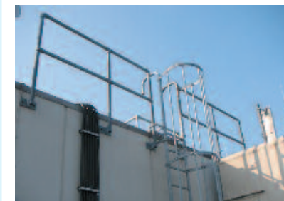
Bild 3-8: Steigleiter mit seitlicher Verbreiterung zur Vorgabe der Gehrichtung
