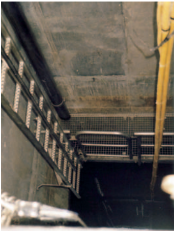
Bild 8: Steigleiter mit Seitenholmen, Steigschutzeinrichtung und Podest
