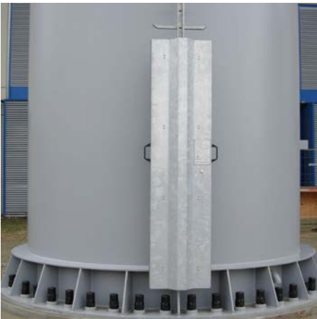
Abb. 14 Steigleiter bis zum Boden geführt und gegen unbefugte Benutzung gesichert
