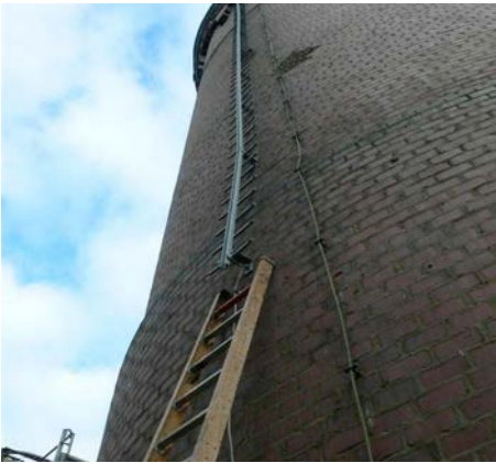
Abb. 13 Unsichere Zugangssituation bei Steigleitern an Schornsteinen
