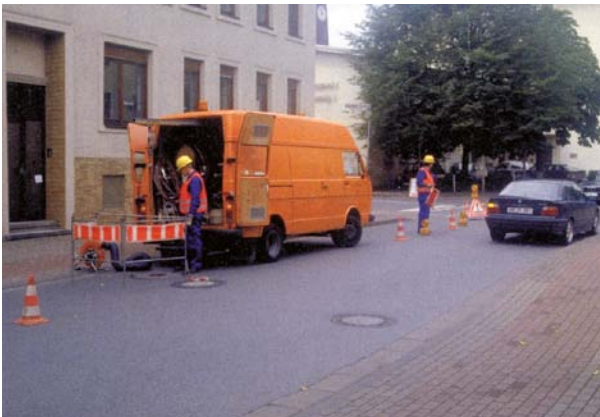
Bild 8: Mit Absperrgitter gesi- cherter Schachtein- stieg
