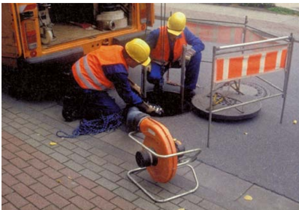
Bild 26: Technische Belüftung (siehe auch Bild 5)
