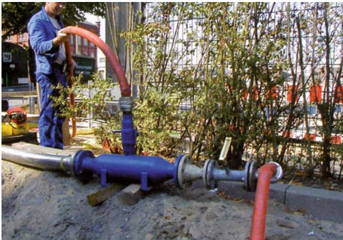
Bild 23: Abkühlen des Mediums mittels Mischkühler
