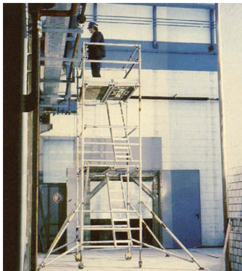
Bild 10: Fahrerüst zur Instandhaltung
