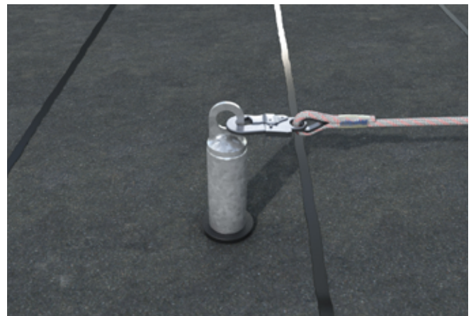
Abb. 57 Beispiel einer Anschlagereinrichtung, die dauerhaft am Bauwerk befestigt ist (Einzelanschlagpunkt-Stahlrohrstütze).
