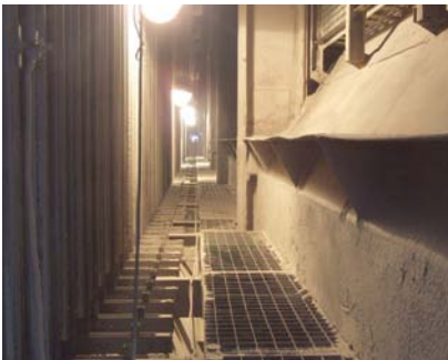
Abb. 8.5.2.1 Beispiel für eine temporäre Beleuchtung in einem E-Filter
