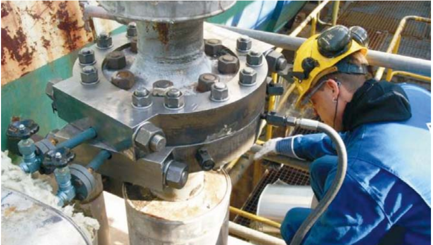
Abb. 7.3 Beispiel für den Einsatz eines Compound-Abdichtverfahrens zur Abdichtung einer Leckage an einer Flanschverbindung
