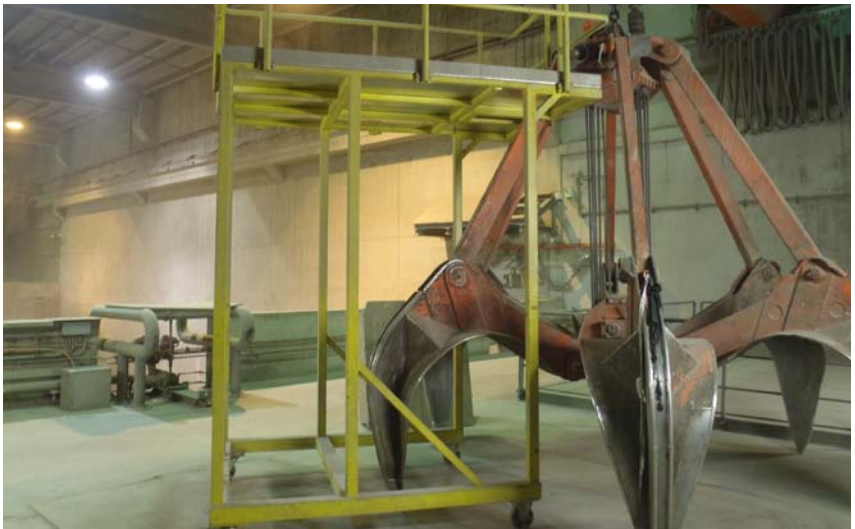
Abb. 14.5.1.2 Beispiel für einen im Bunkerbereich für geringfügige Wartungsarbeiten abgestellten Müllgreifer. Die fahrbare Arbeitsbühne erleichtert die sichere Durchführung der Arbeiten.
