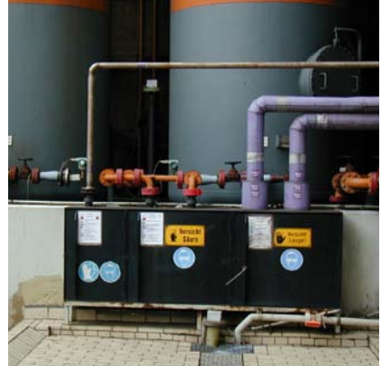
Abb. 12.4.2.2 Kennzeichnung einer Entlade-station. Die spezifischen Anschlussstutzen werden in den Schränken bereitgehalten.
