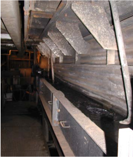
Abb. 10.2 Sicht auf das Wasserbecken einer Entschungsanlage. Gefährdungen durch austretendes Wasser und Wasserdampf sind möglich.
