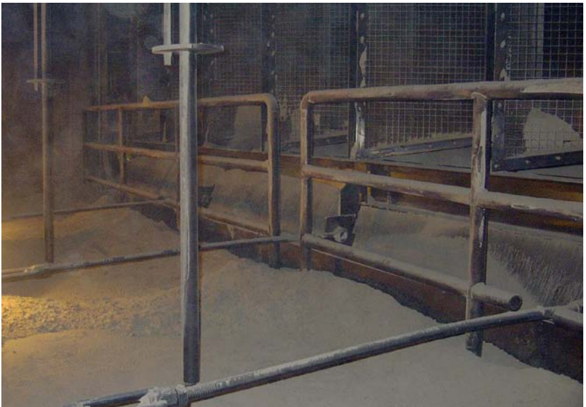
Abb. 8.5.4.1 Beispiel für ein festes Geländer als Absturzsicherung in einem Rauchgaskanal am Übergang zur Entstickungsanlage. Nach Einbringen der Beleuchtung kann mit den Reinigungsarbeiten begonnen werden.
