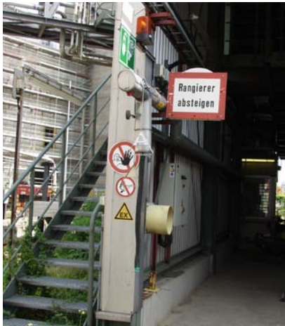
Abb. 12.1.1.1 Eingehauste Beladeanlage für Flugstäube mit Sicherheitskennzeichnung
