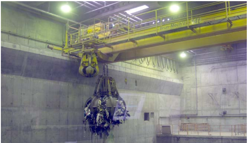
Abb. 14.4.1 Blick in einen Müllbunker mit Müllaufgabetrichter im Vordergrund. Die hinter dem Aufgabetrichter liegende Fläche gestattet ein Begehen des Bereiches und ein Abstellen z.B. von Ersatzmüllgreifern.
