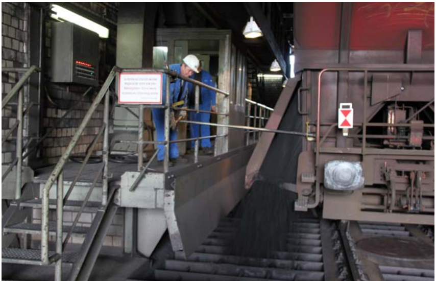
Abb. 12.1.4.1 Öffnen einer Waggonklappe durch eine ausreichend lange Betätigungsstange. Der Bedienvorgang kann sicher von einer mit Seitenschutz ausgeführten Rampe durchgeführt werden.
