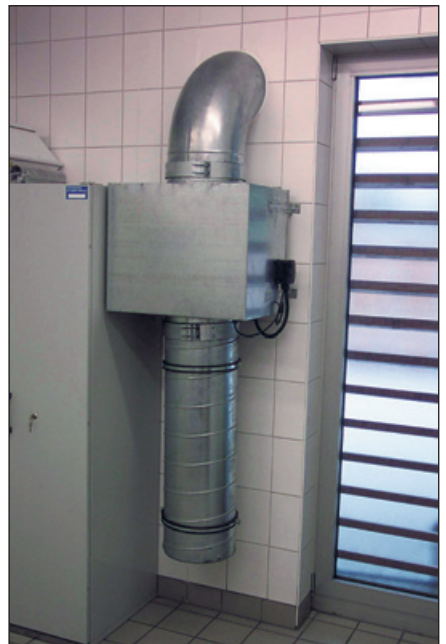
Abbildung 9: techn. Lüftung mit Absaugung im Bodenbereich
