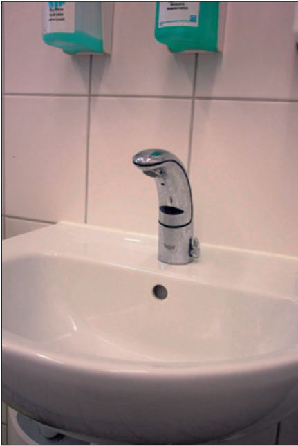
Abbildung 8: Handwaschbecken mit berührungslos zu betätigender Armatur
