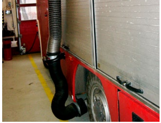
Bild 27 Regelkonform installierte Abgasabsaugung
