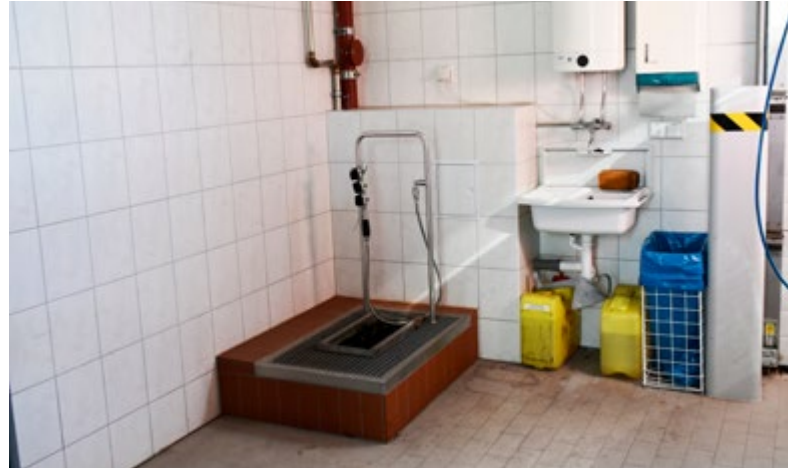
Bild 14 Stiefelwäsche außerhalb des Verkehrsweges
