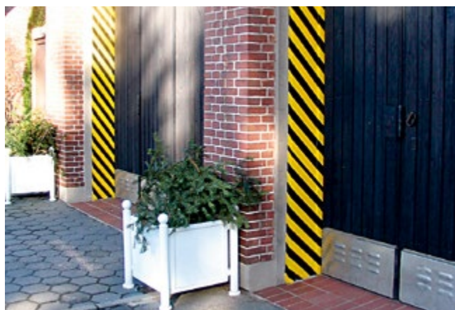
Bild 23 Kennzeichnung der Torlaibungen bei fehlenden Sicherheitsabständen
