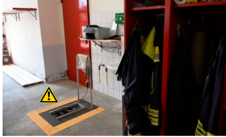
Bild 13 Stiefelwäsche als Hindernis im Alarmweg
