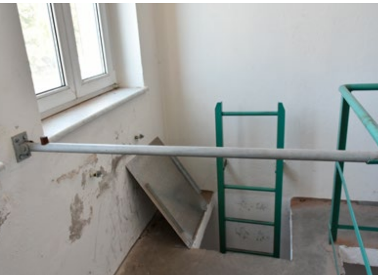
Bild 49 Einzelfalllösung am Arbeitspodest zur Sicherung gegen Absturz
