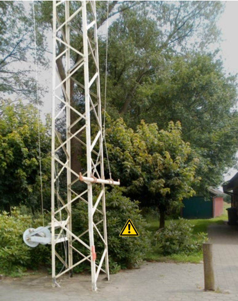
Bild 50 Ungesicherter Schlauchmast neben dem Feuerwehrhaus
