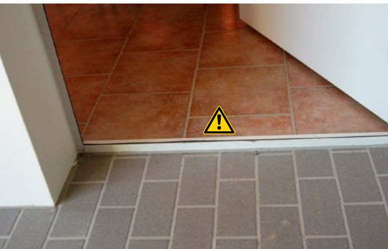
Bild 10 Stolperstelle im Eingang ins Feuerwehrhaus
