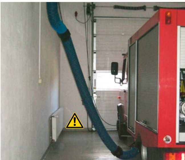
Bild 28 und 29 Durch Abgasschläuche versperrte Verkehrswege
