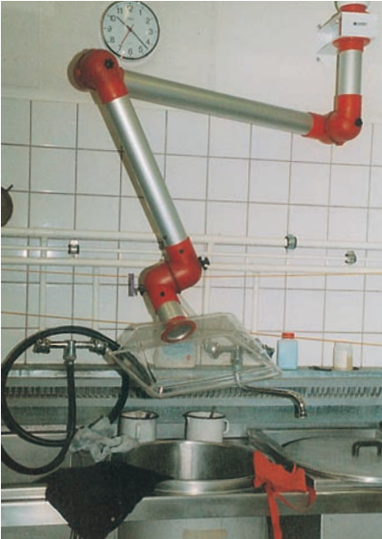
Abbildung 12b: Flexible Punktabsaugung über einem Färbebecken (Landmann)
