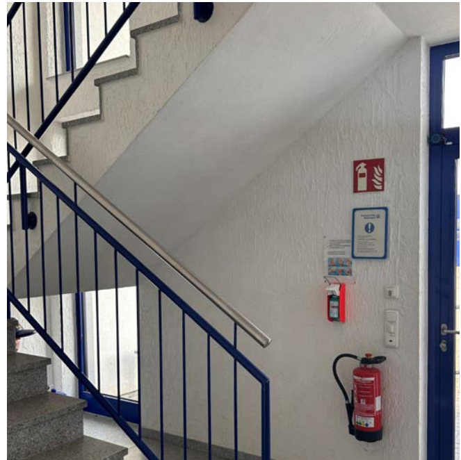
Abb. 5 Feuerlöscher im Stützpunkt
