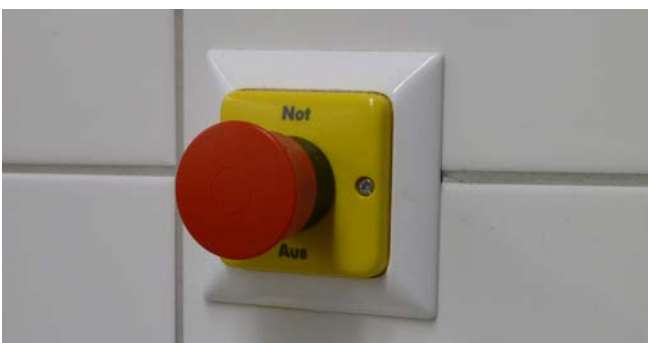
Abb. 4 Zentrale Netztrenneinrichtung für den Fall eines Fritteusenbrandes oder Elektrounfalls
