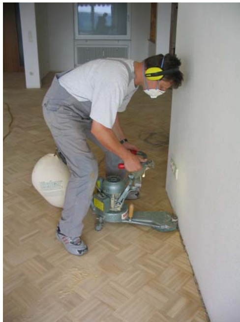
Abbildung 2-32: Zwangshaltung beim Parkettschleifen mit einer Randschleifmaschine
