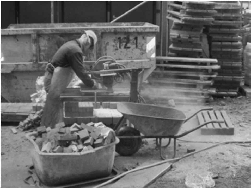
Abbildung 43: Ungenügend wirksame Nasstrennsäge, da zu wenig Wasser zugeführt wird und außerdem das Wasser im Umlauf verwendet wird
