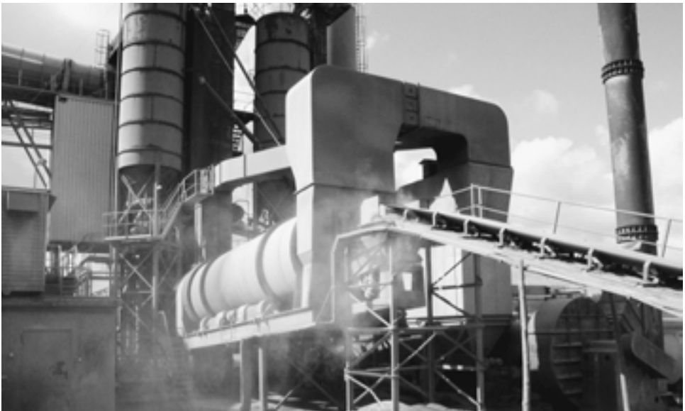
Abbildung 28: Trockentrommel einer Asphaltmischanlage
