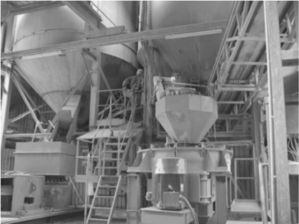
Abbildung 23: Brecheranlage im Kieswerk
