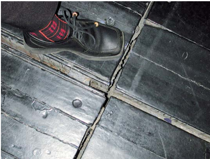
Abbildung 2: Holzfußboden einer multifunktionalen Bühne mit Bühnenwagenschiene und Spalten
