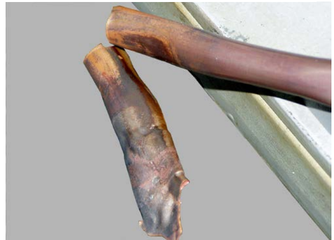
Überreste eines geplatzten Heizungsrohrs
