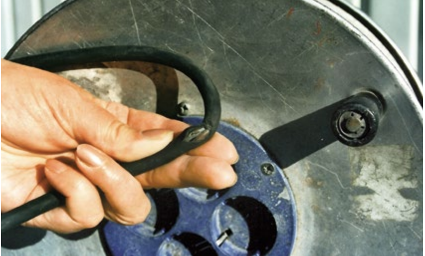
Abb. 3.4 Beschädigte und für den Bereich Bau- und Montagestellen ungeeignete leichte Gummischlauchleitung Typ H05RR-F; außerdem weisen die Steckdosen nicht die notwendige Schutzart IP X4 auf.
