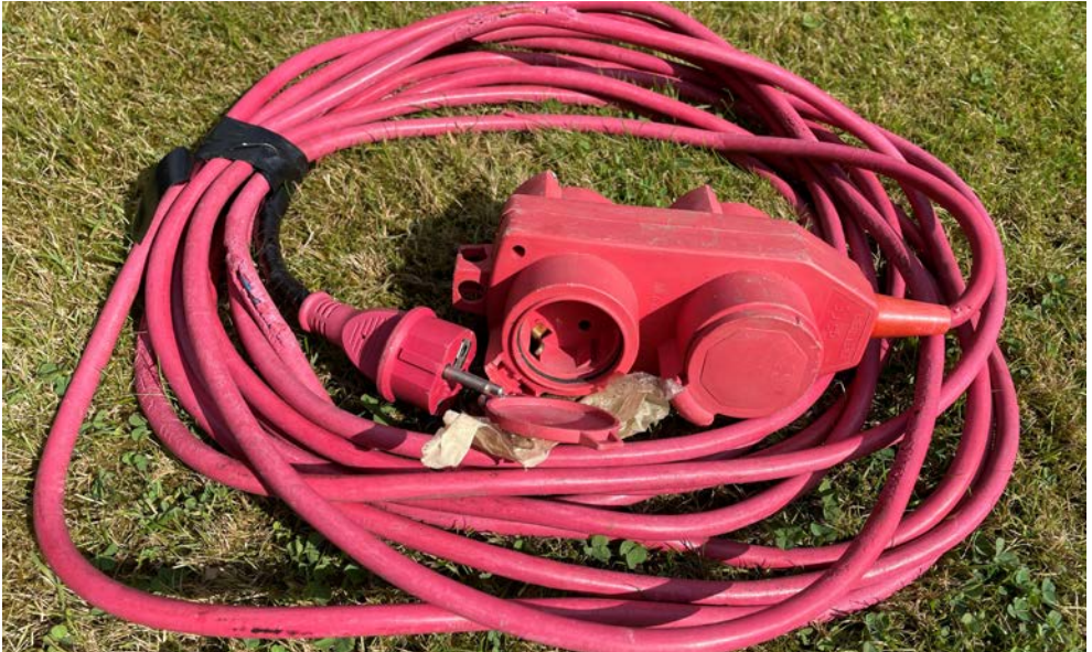
Abb. 5 Für den Bereich Bau- und Montagestellen ungeeignete PVC-Schlauchleitung mit diversen Beschädigungen
