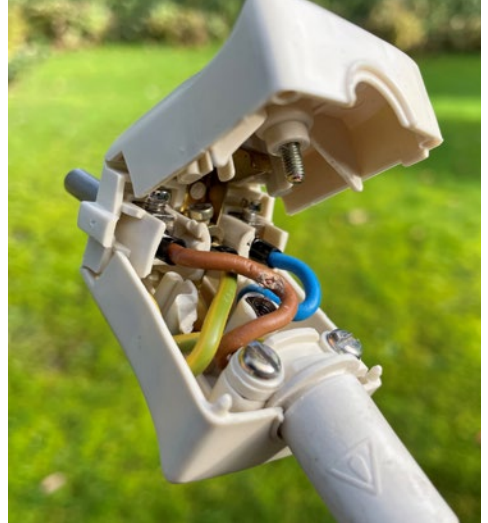
Abb. 10 Beispiel eines Isolationsfehlers aufgrund einer fehlerhaften Montage
