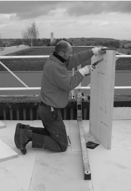
Abbildung 5: Knien ohne Abstützung, beidbeinig (Dachdecker)
