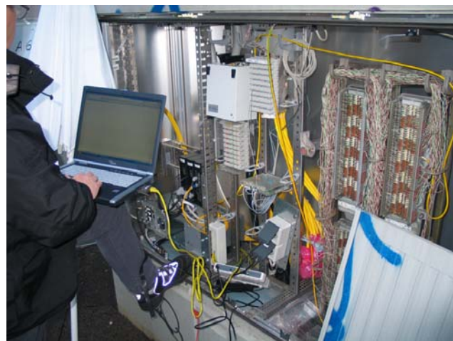
Servicetechniker im Einsatz – Wartung eines Schaltkastens
