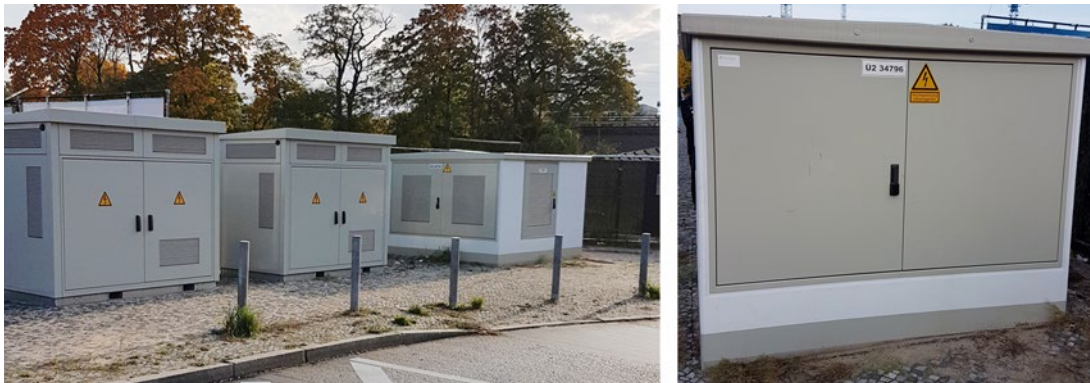
Abb. 9 links.: Schalterhäuschen, rechts.: Transformatorhäuschen mit ID-Nummer
