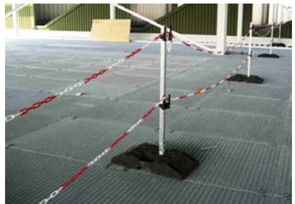
Abb. 4-8 Im sicheren Abstand zur Absturzkante (größer 2,0 m) abgesperrte Gitterrostbühne
