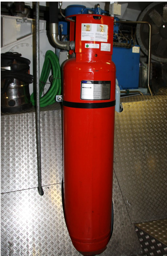
Abb. 8 Die BinSchUO regelt die Prüfung der FL-Anlage
