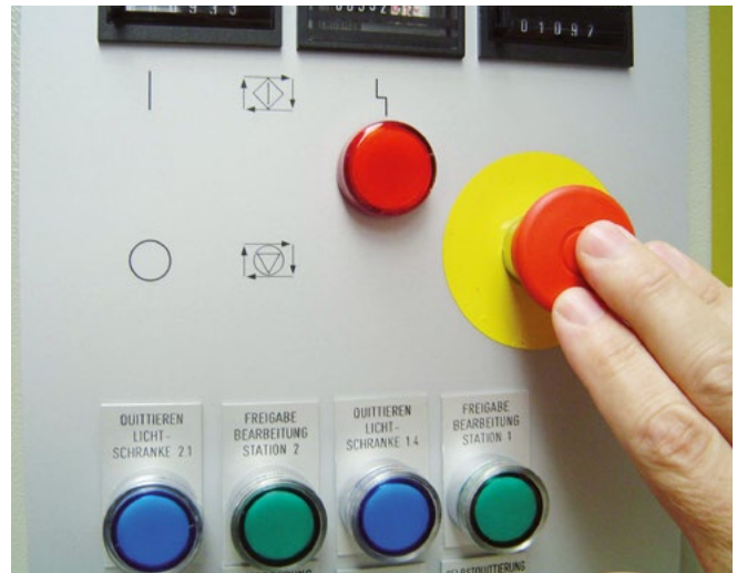
Abb. 32 Not-Halt-Befehlsgerät an einer Roboteranlage [H]
