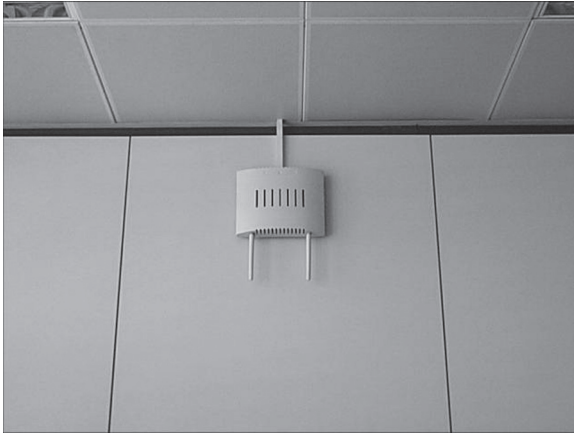
Abbildung 19: Access Point für DECT-Anlagen
