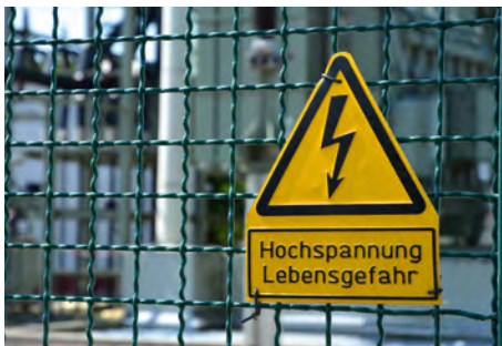
Gute Kennzeichnung der Arbeitsgrenzen in einer Freiluft-Schaltanlage
