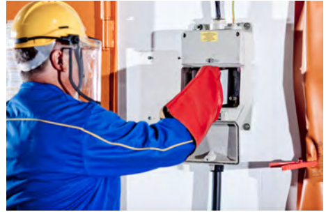
Ziehen eines NH-Sicherungseinsatzes
