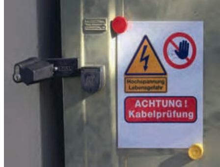
3.3.2 Bild 2 Sicherung einer Stationstür mit Spezialschloss, Warnschild
