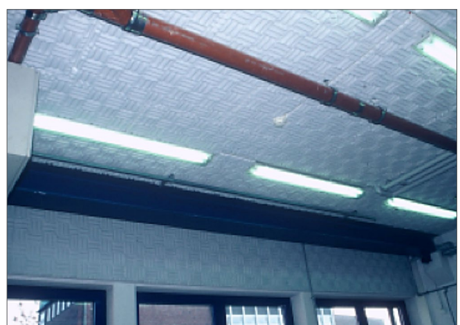
Abb. 6.2 Direkt an Decke und Wände verklebte Absorber aus Melaminharzschaum mit gewellter Oberflächenstruktur.
