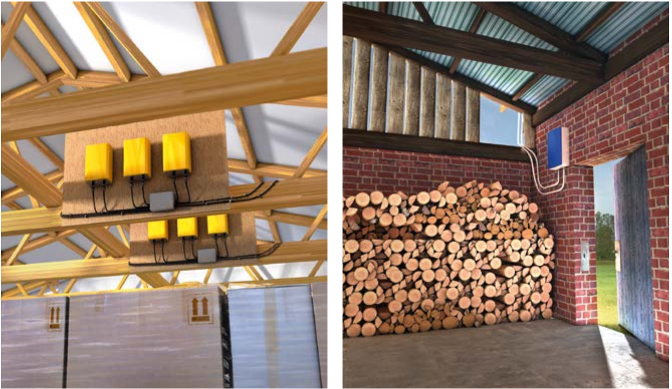
Abb. 34 Unzulässige Montage in „feuergefährdeten Betriebsstätten“
