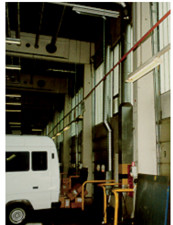
Bild 12b Abluft über Absaugrohre an der Seitenwand
