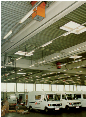
Bild 12a Zuluft im Deckenbereich
