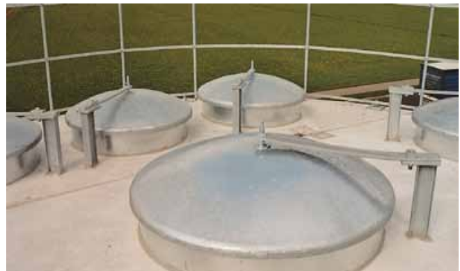
Abb. 9.9 Explosionsklappen im Deckenbereich eines Silos
