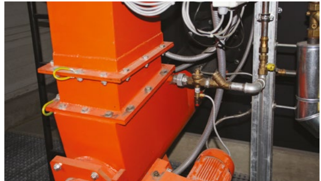
Abb. 6.23 Fallschacht von einer Siloaustragung zur Stoker-Schnecke
