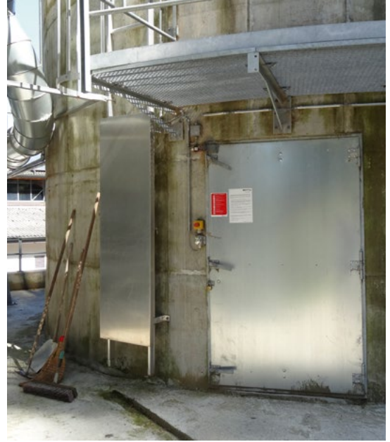
Abb. 5.14 Sicherung des Steigleiterzuganges Anlegeleiter mit einhängbarer und abschließbarer Blechtefel
