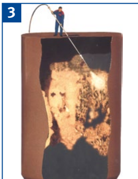
Beseitigen von Fließstörungen im Silo nach Möglichkeit von außerhalb beseitigen, nur im Notfall einfahren.
