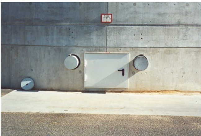
Abb. 7.8 Außerhalb des Silokörpers gelegene Anschlussstutzen für eine Transportanlage mit Umschaltweiche für die Austrageinrichtung (befindet sich hinter der verschlossenen Tür)
