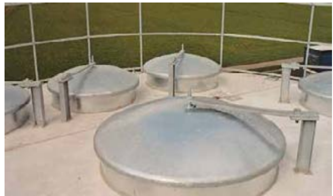
Abb. 9.9 Explosionsklappen im Deckenbereich eines Silos
