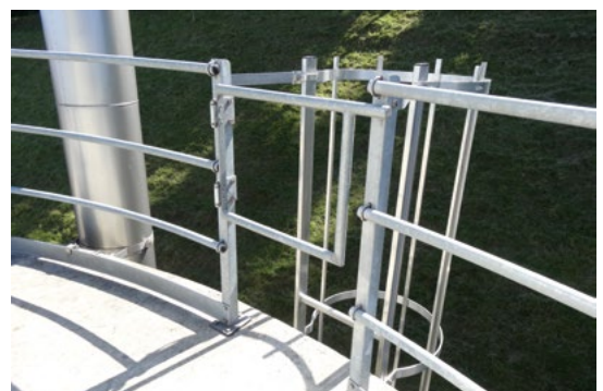
Abb. 5.15 und 5.16 Silodach mit Absturzsicherung und sicherheitsgerechter Ausführung des Leiterausstieges
