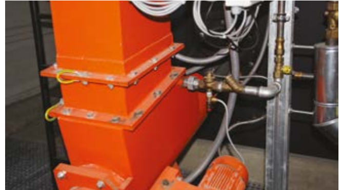
Abb. 6.23 Fallschacht von einer Siloaustragung zur Stoker-Schnecke
