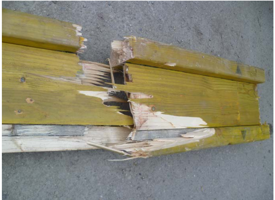
Bruchstelle im Schalungsträger
