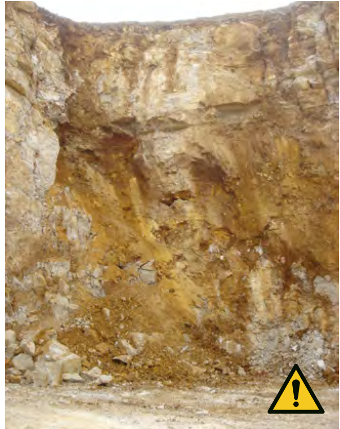
Abb. 2 Gefährdungen im Bereich der Bruchwand durch Unterhöhlung
