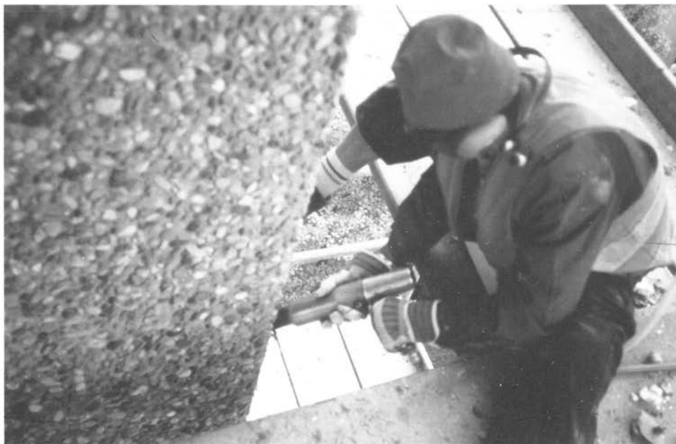
Abbildung 45: Waschbetonfassade nadeln (E 69)
