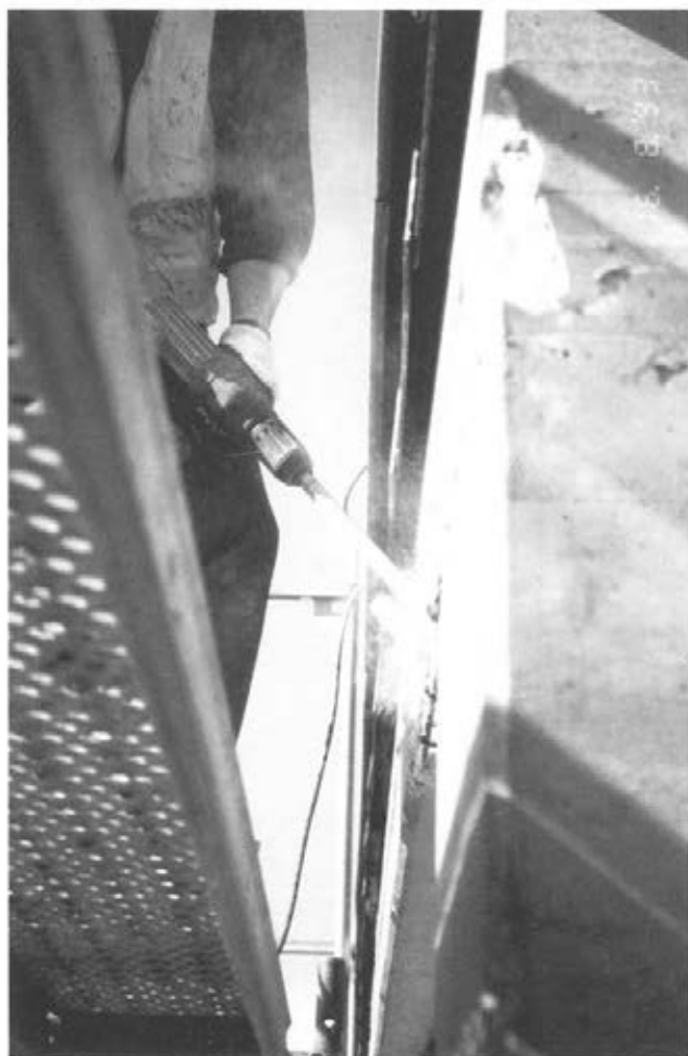
Abbildung 28: Lose Betonteile abstemmen (E 36)
