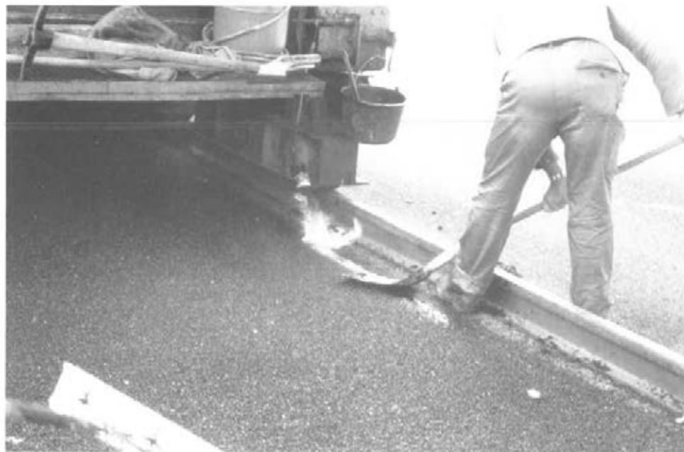
Abbildung 27: Mitgänger am Gußasphaltpfeger (C2 28)
