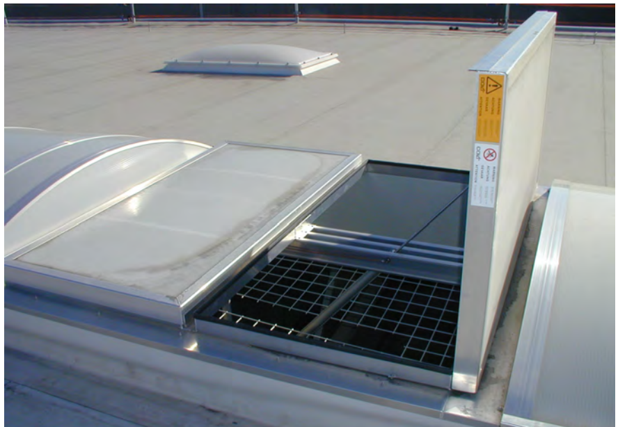
Metallgitter als Durchsturz sicherung im Lichtband auf einem Hallendach
