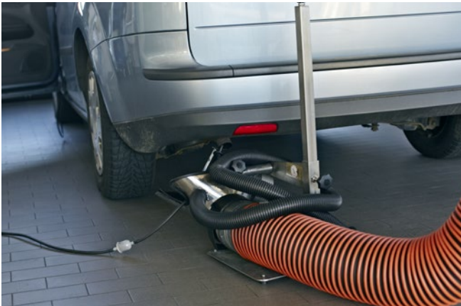
Abb. 17-1 Abgasabsaugung mit oberirdischer Anlage
