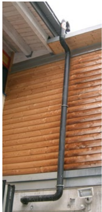
Abb. 6 Wasserstoffableitung über Dach
