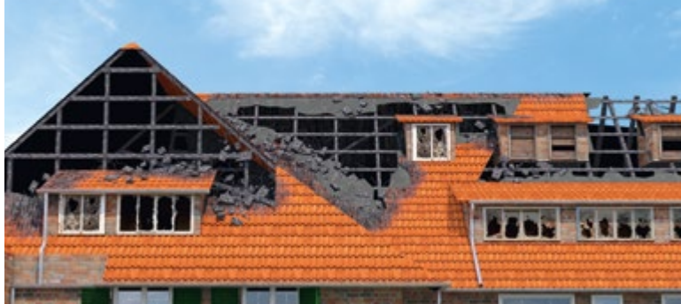
Abb. 20 Gebäude nach einem Dachstuhlbrand
