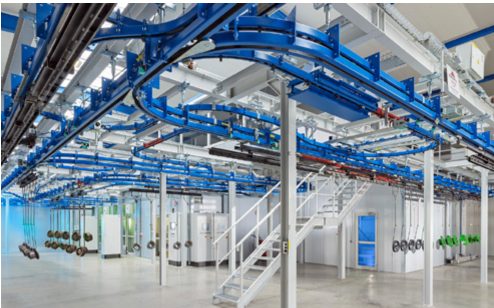
Abb. 3: Integration einer komplexen Lackieranlage in ein Gebäude
