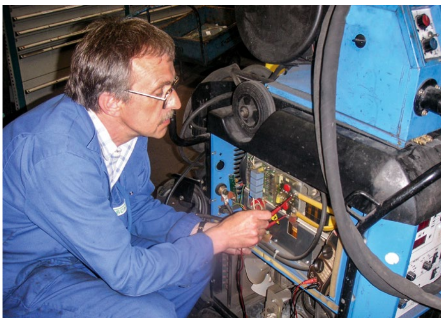
Abb. 4-6 Arbeiten an einer Schweißstromquelle nur durch Elektrofachkraft zulässig
