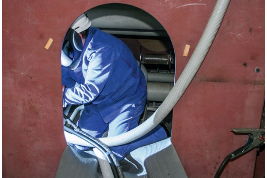
Abb. 5-1 Beispiel für erhöhte elektrische Gefährdung beim Schweißen
