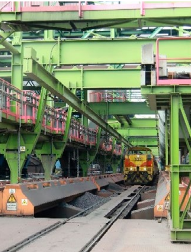
Bild 5 Bunkeranlage für Erz und Zuschlagsstoffe
