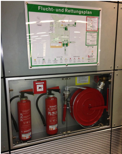
Abb. 53 Bereitstellung von Feuerlösch-einrichtungen
