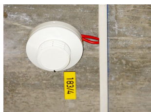
Abb. 33 Rauchmelder an einer Raumdecke
