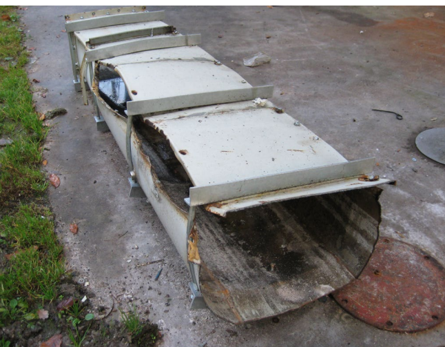
Abb. 29 Zerstörte Filterelemente (Quelle: BGN)
