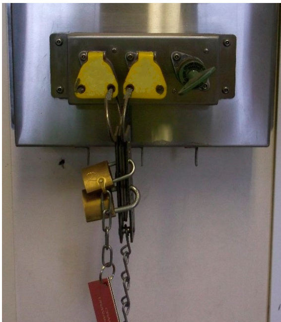
Abb. 40 Beispielhafte Lockout/Tagout-Maßnahme: Mit Vorhängeschlössern gesicherte Staubkappen (gelb) einer Schlüsselwechselstation verhindern das Einstecken der Schlüssel. Schließbügel ermöglichen das Anbringen mehrerer Vorhängeschlösser (vergl. Abb. 41).
