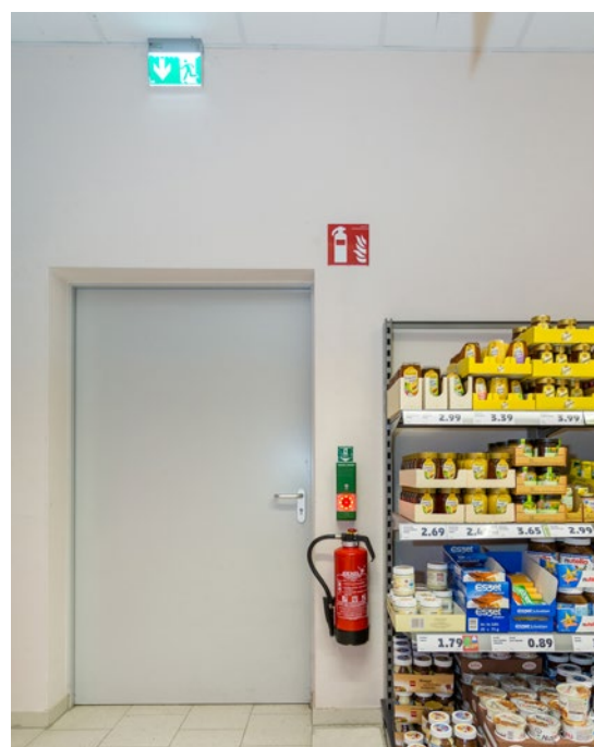
Abb. 26 Feuerlöscher gut erreichbar in Greifhöhe
