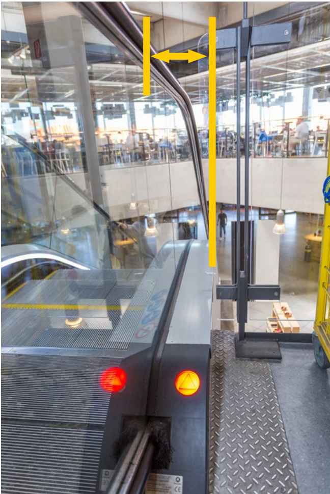
Abb. 45 Der Abstand zwischen Handlauf der Fahrtrepppe und feststehenden Teilen muss mind. 80 mm betragen.
