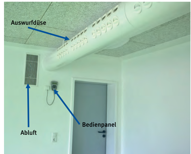
Abbildung 27: Eingebaute Auswurfdüse für die Zuluft, Abluftdurchlass und Bedienpanel im Bestandsbau
