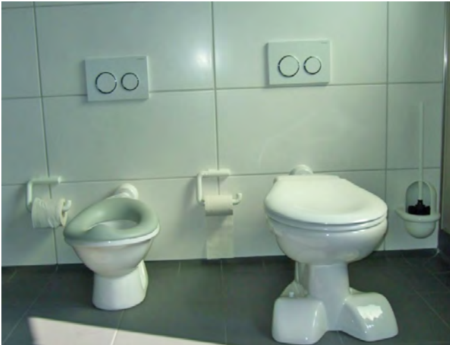
Abbildung 101: Toiletten in unterschiedlichen Höhen tragen dem Montessori-Konzept Rechnung, den Kindern die Möglichkeit zur Eigenständigkeit zu bieten.
