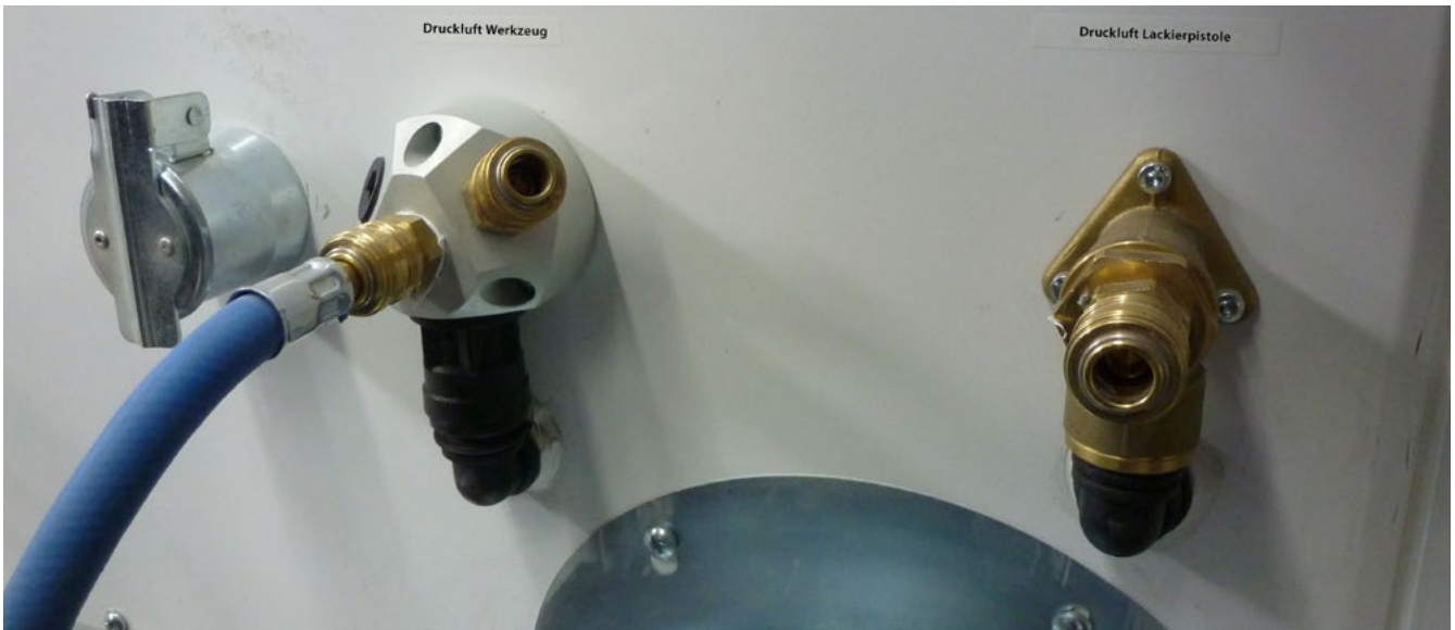
Abb. 9 Separate Druckluftversorgung für Handwerkzeuge und Lackierpistolen
