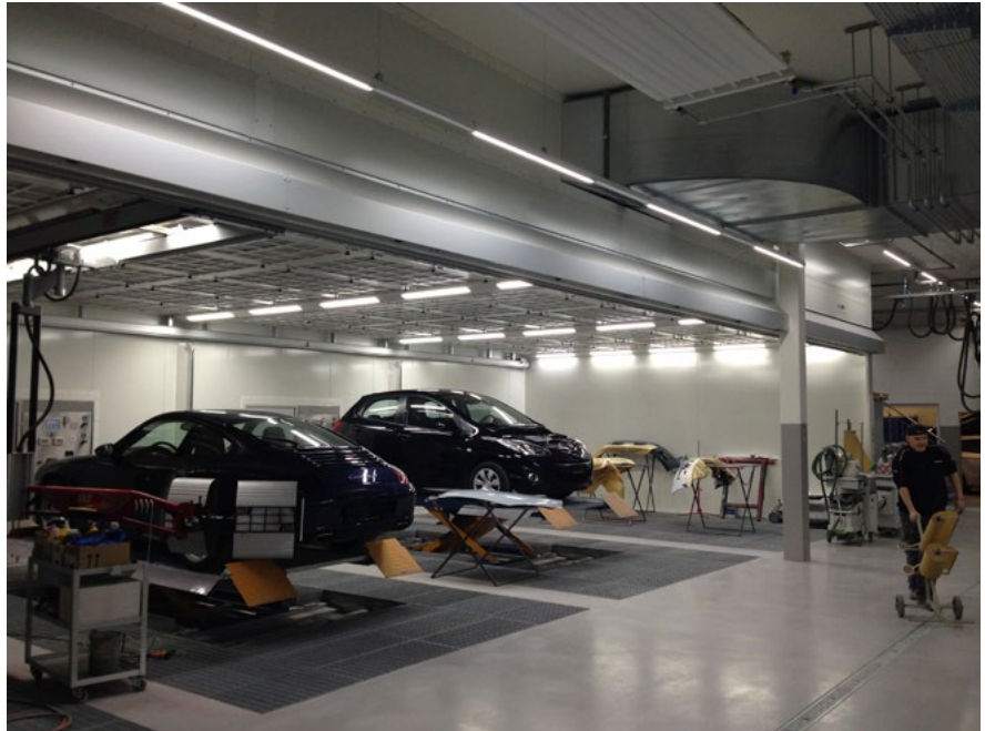
Abb. 3 Vorbereitungsplätze mit vertikal angeordneter technischer Lüftung: Zuluft von oben, Absaugung im Boden
