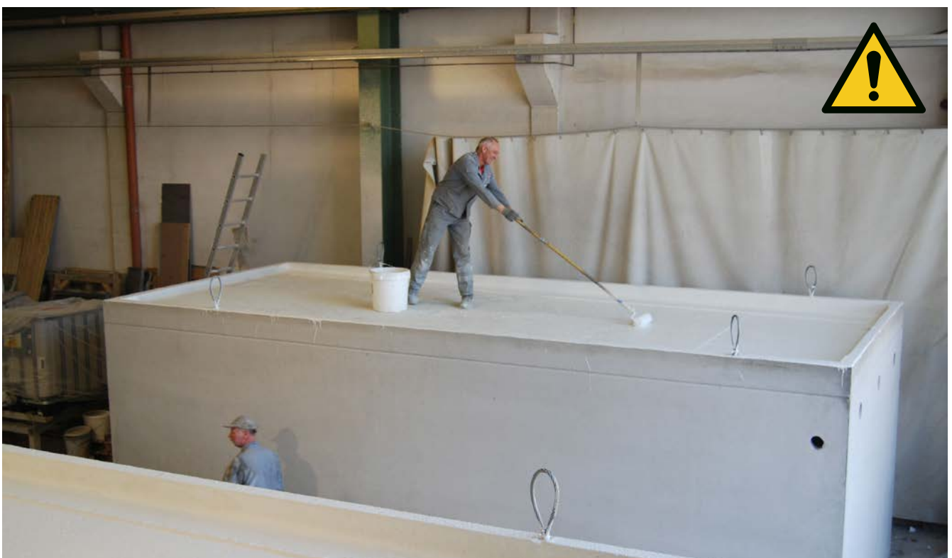
Abb. 87 NEGATIV: Arbeiten ohne Absturzsicherung
