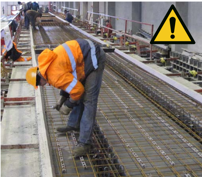
Abb. 24 Zwangshaltung bei Bewehrungsarbeiten (negativ!)
