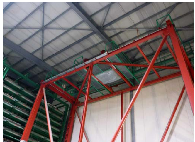
Abb.11 Arbeitsbühne für Wartungsarbeiten am Hubwerk des Regalbediengerätes
