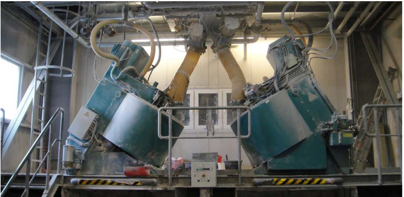
Abb. 89 Mischanlage mit Abluftabsaugung
