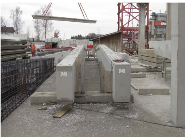
Abb. 111 Gefahren durch Unordnung und fehlende Sauberkeit
