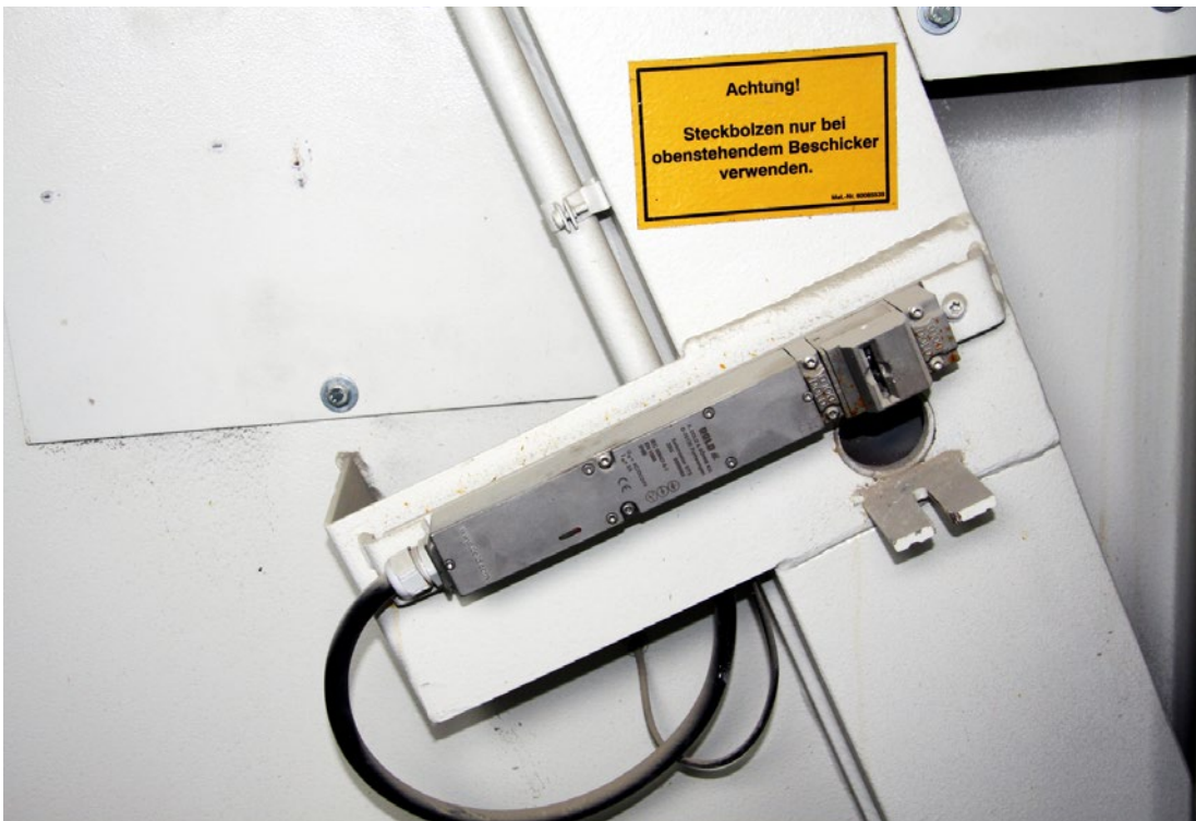
Abb. 25 Stellungsüberwachung für den Steckbolzen der Kübelaufzugsbahn
