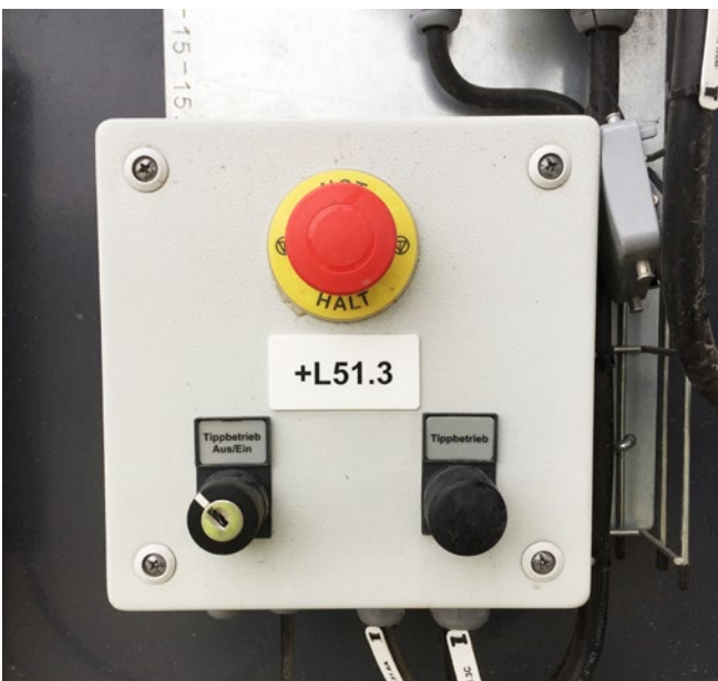
Abb. 18 Vor-Ort-Steuerung um Becher des Becherwerkes zu positionieren
