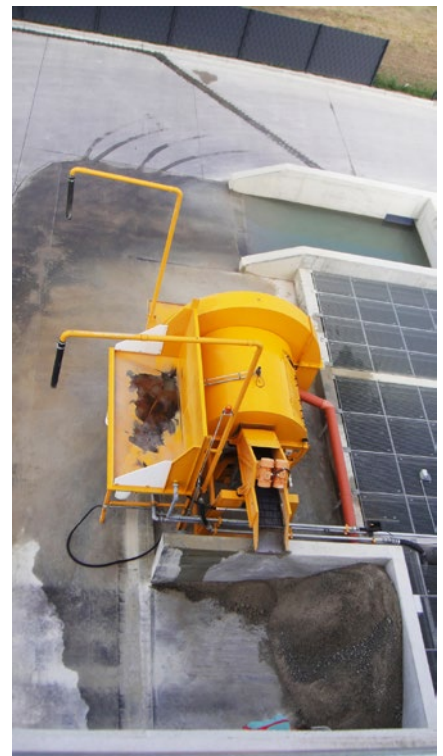
Abb. 28 Recyclinganlage mit abgedecktem Becken
