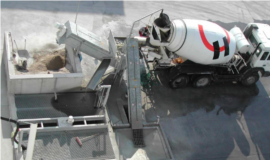
Abb. 36 Recyclinganlagen mit abgedeckten Absetzbecken
