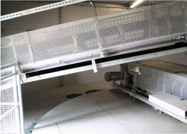
Abb. 20 Gurtbandförderer mit erforderlichen Schutz- und Sicherheitseinrichtungen
