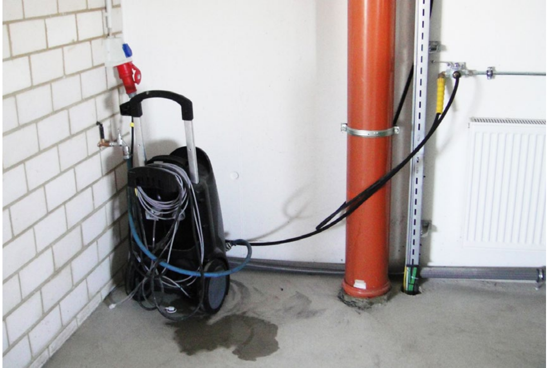
Abb. 26 Zentral untergebrachter Hochdruckreiniger für Reinigungsarbeiten mit Verteilleitung
