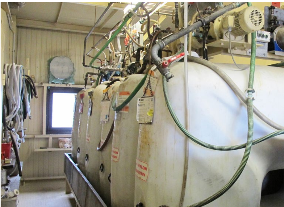
Abb. 11 Lagerung von Beton- zusatzmitteln
