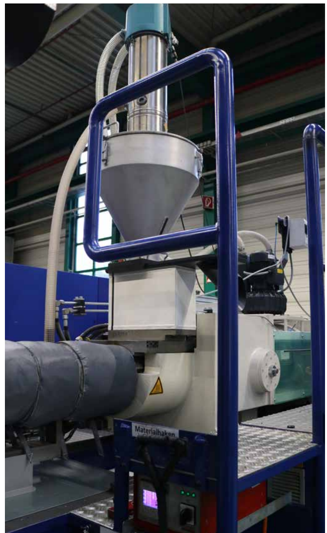
Abb. 62 Fest installierter Aufstieg an einer Spritzgießmaschine
