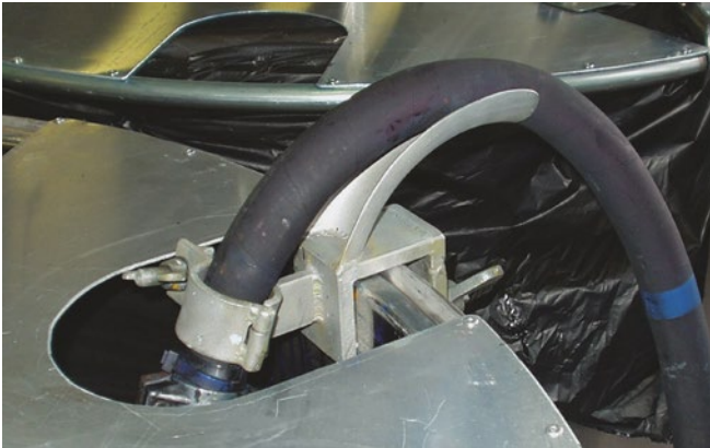
Abb. 3 Befestigung einer Schlauchleitung am Kesselrand
