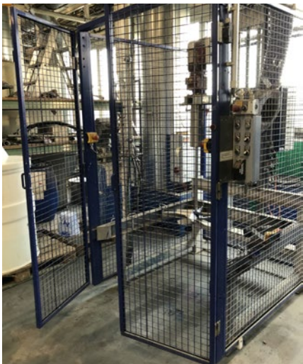
Abb. 9 Schutzgitter mit elektrischer Verriegelung als trennende Schutzeinrichtung
