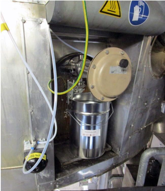
Abb. 25 Pneumatisches Probenahmeventil am Mischer
