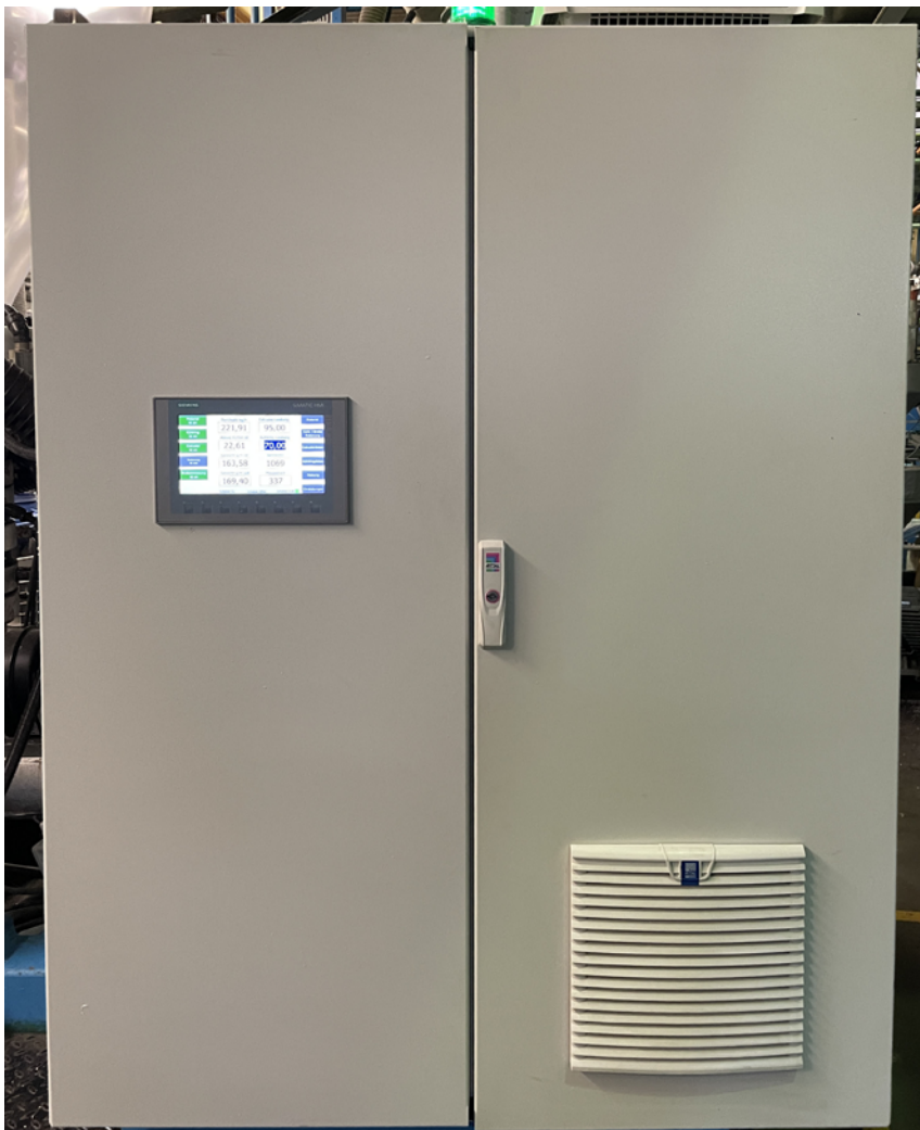
Abb. 32 Vorschriftsmäßiger Schaltschrank an einer Folienblasanlage
