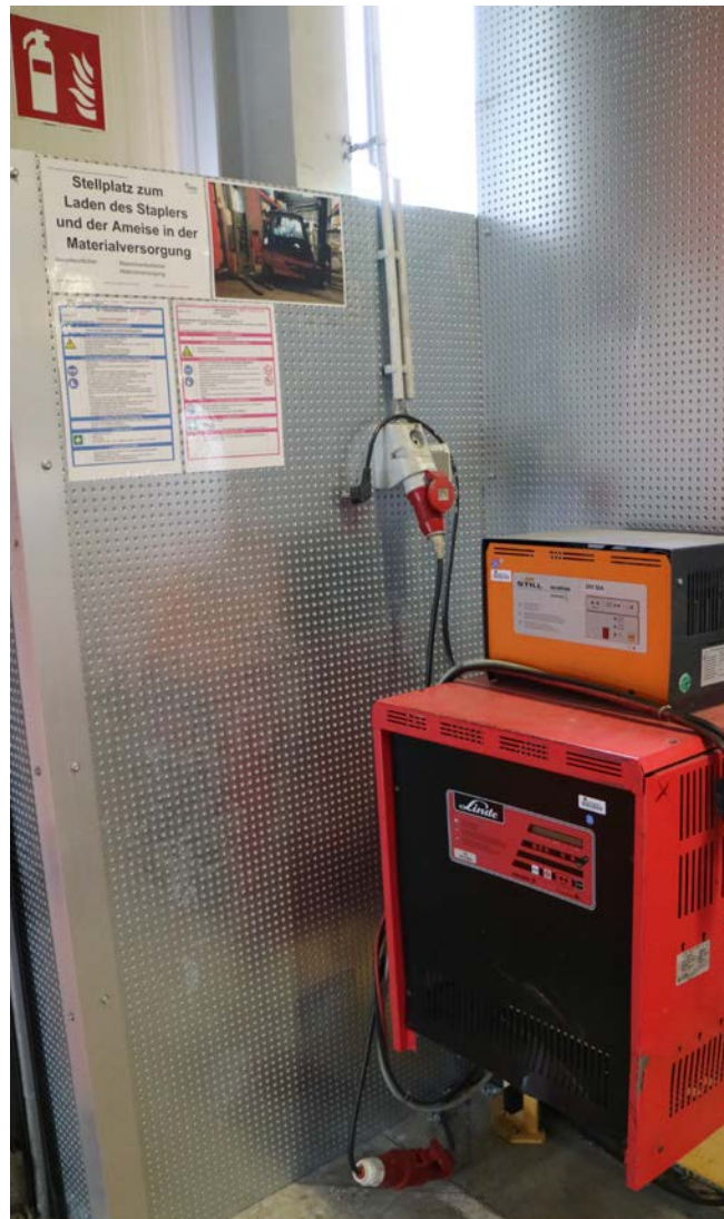
Abb. 27 Gut geschützte und frei gehaltene Ladestation für Gabelstapler
