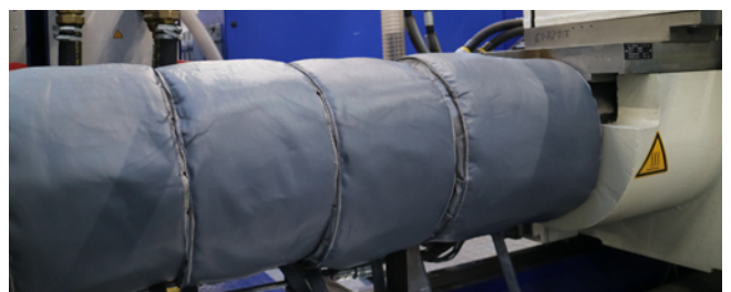
Abb. 8 Gute Praxis für eine Isolation an einer Plastifiziereinheit zur Vermeidung von Verbrennungen
