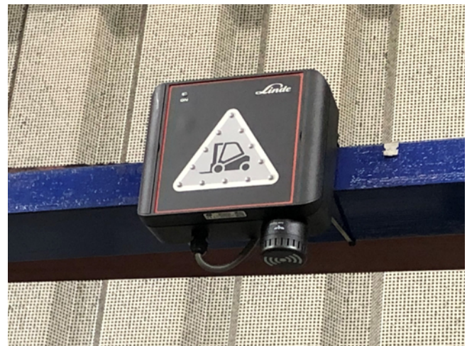
Abb. 18 Sensorik zur automatischen Begrenzung der Geschwindigkeit von Gabelstaplern in Gefahrenbereichen
