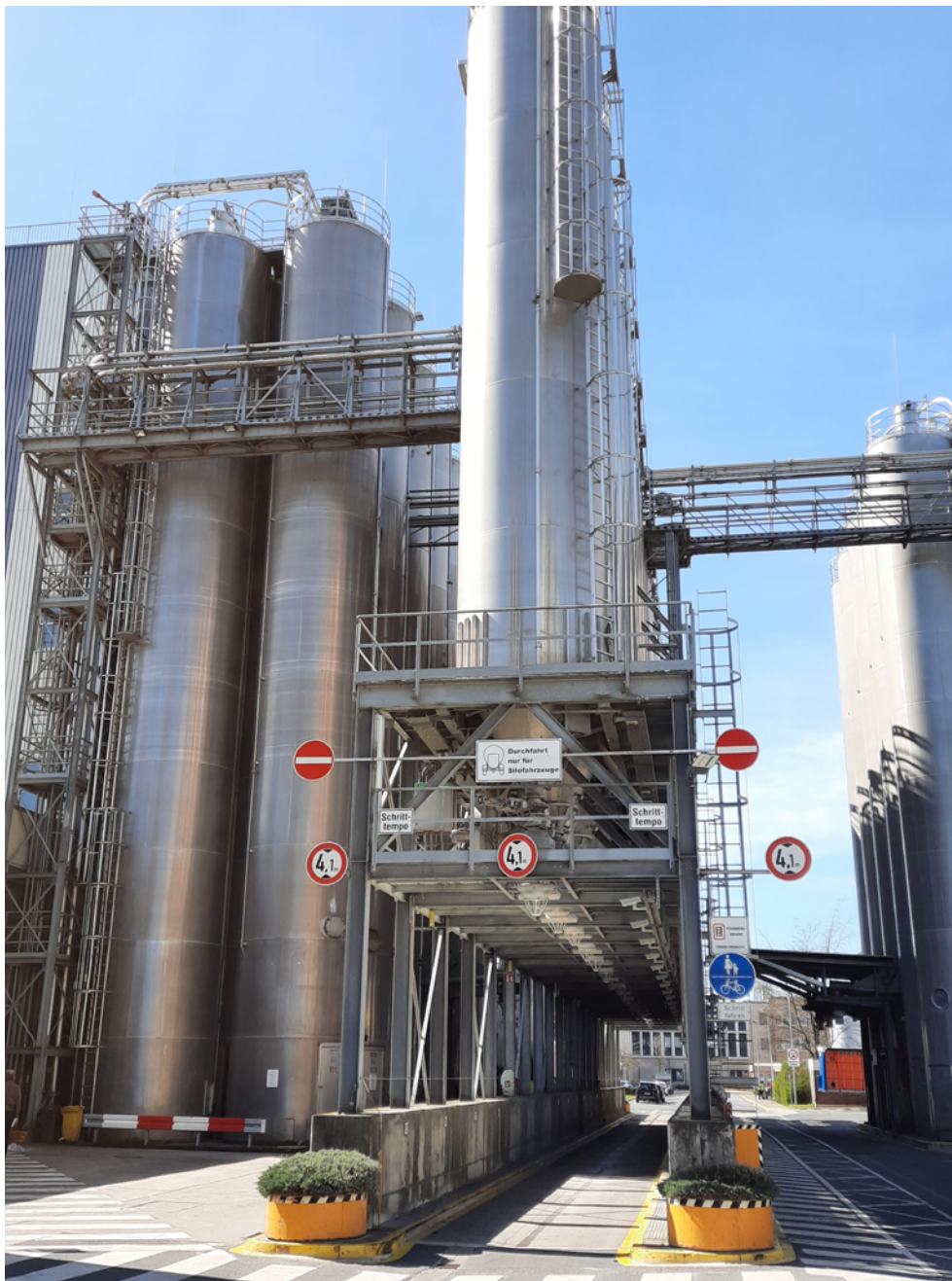
Abb. 68 Silos für Kunststoffgranulat
