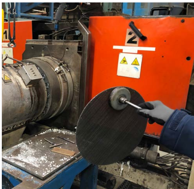
Abb. 55 Einbau eines neuen Siebes mit magnetischer Haltehilfe
