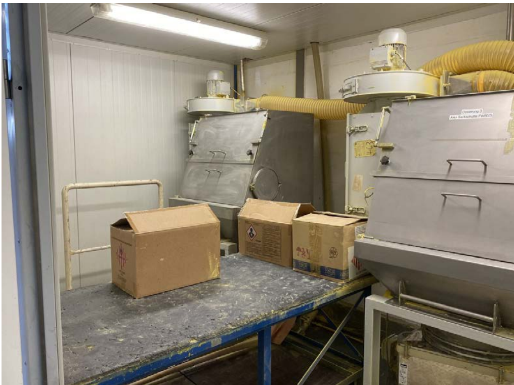
Abb. 81 Separater, mit einer raumlufttechnischen Anlage ausgestatteter Raum zum Abwiegen und Dosieren von pulverförmigen Treibmitteln
