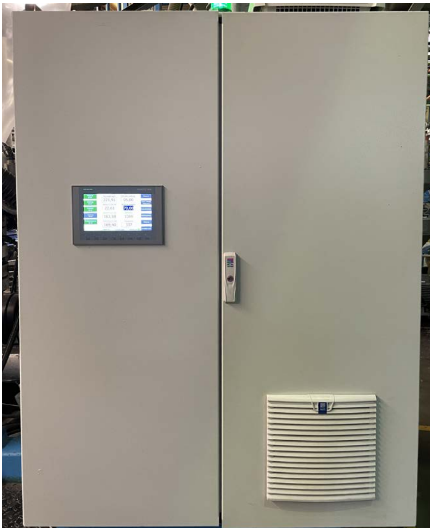
Abb. 32 Vorschriftsmäßiger Schaltschrank an einer Folienblasanlage
