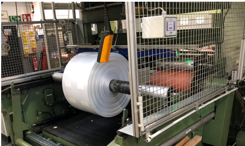
Abb. 38 Kontaktwickler mit nachgerüstetem Schutzgitter
