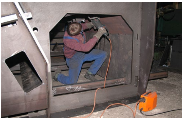
Abb. 25 Schleif- und Trennarbeiten in einem leitfähigen engen Raum mit Trenntransformator (Quelle: DGUV Information 203-004)
