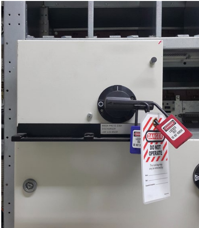
Abb. 10 Sicherung des Hauptschalters mit Vorhängeschloss und Warnhinweis
