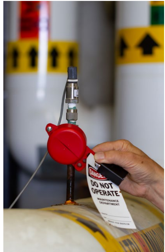
Abb. 13 Absperrvorrichtung eines Durchgangsventils gegen unbefugtes Öffnen
